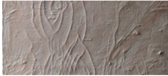
Illustration 57. Vue en lumière rasante des soulèvements en toit.
